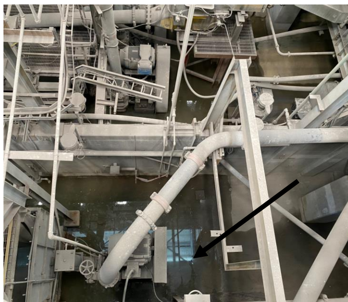
Figura No. 33. Presencia de agua en áreas
