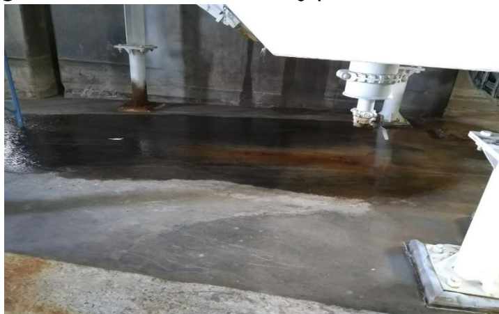
Figura No. 11. Área húmedas y presencia de óxido
