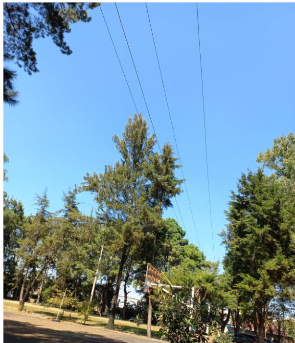
Figura 5: Línea de transmisión 13.2 kV
