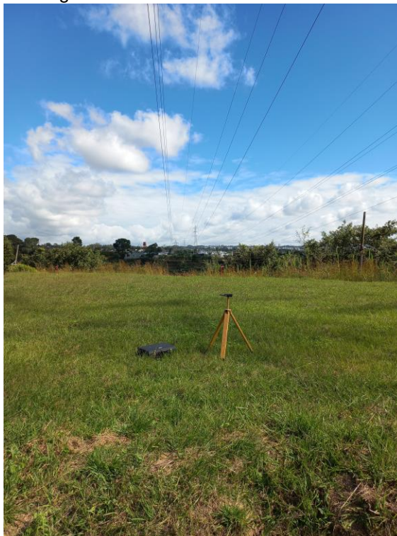
Figura 7: Medición en la línea de 69kV
