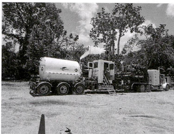
Fotografía 6. Unidad de inyección de nitrógeno.
