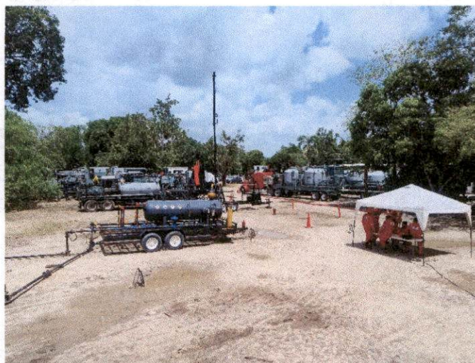
Fotografía 7. Separador Trifásico Horizontal:
