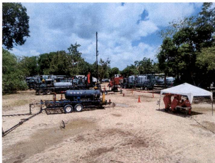
Fotografía 7. Separador Trifásico Horizontal:
